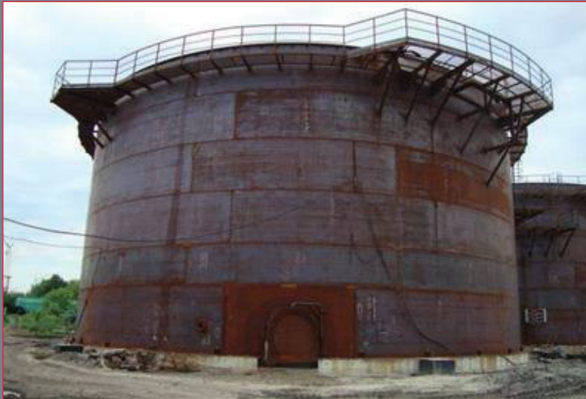
Резервуар PBC-5400, біогазовий реактор
